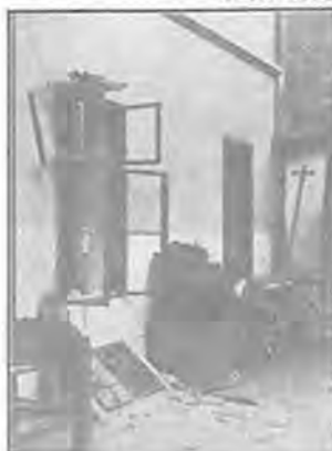
Prozor strojarnice izvana: Iznad prozora vidi se probijen zid i raskidana prozornica, na zemlji komadi zida i prozornice.
